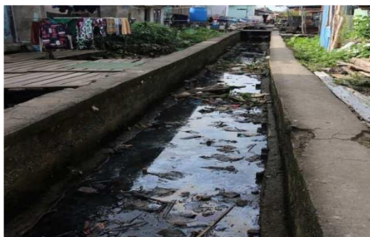
Gambar 7. Air selokan bau dan tergenang
